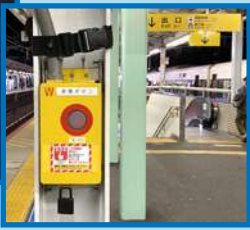
ホーム非常ボタン
